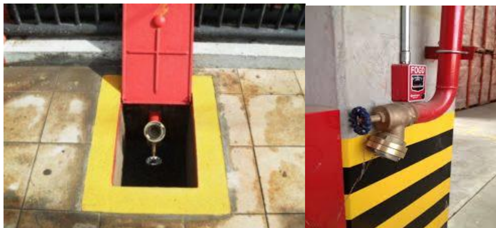
Figura 183 - Hidrante de recalque
