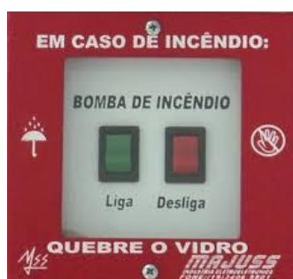
Figura 180 - Botoeira da bomba de incêndio
