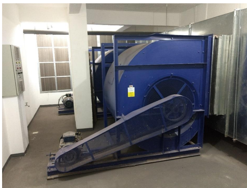
Figura 177 - Grupo de moto ventiladores
