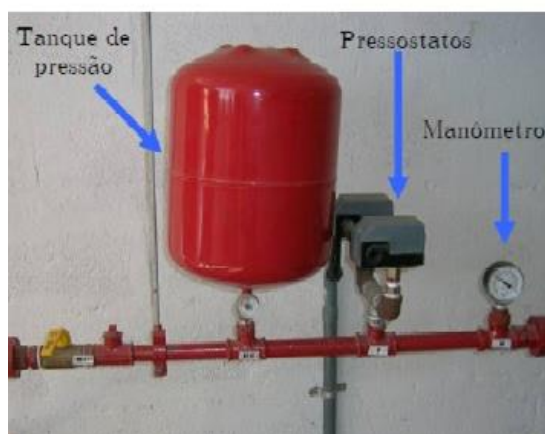
Figura 182 - Tanque de pressão, pressostatos e manômetro
