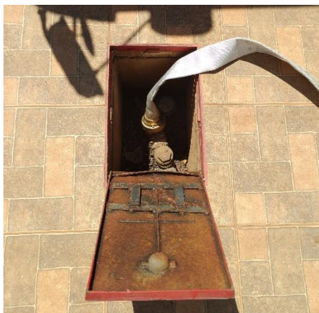
Figura 193 - Hidrante de recalque com a ligação conectada
