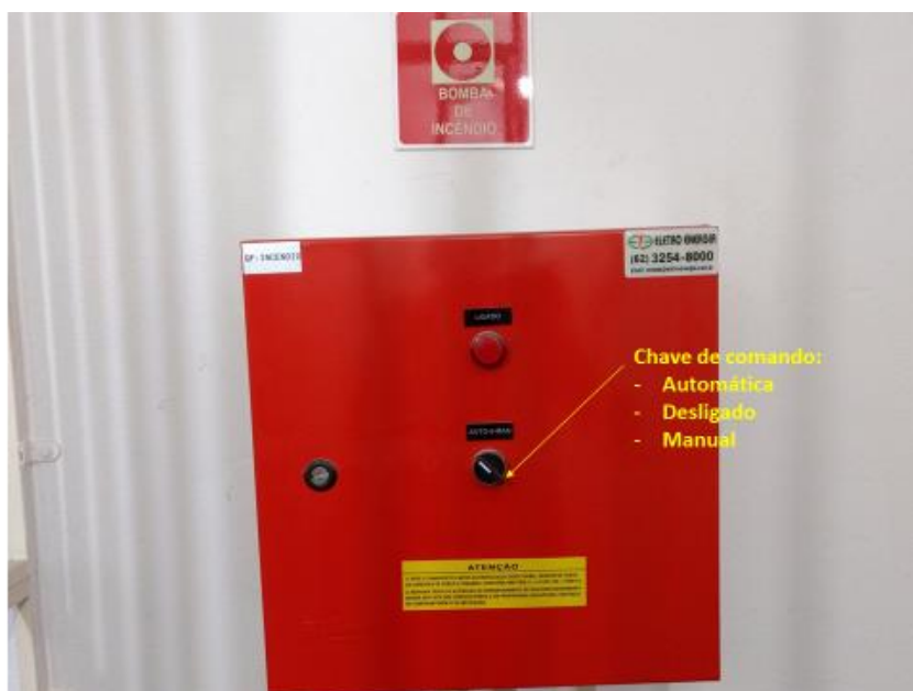
Figura 179 - Painel de comando da bomba de incêndio
