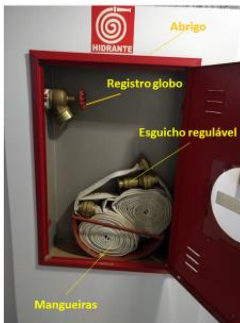
Figura 178 - Hidrante de parede
