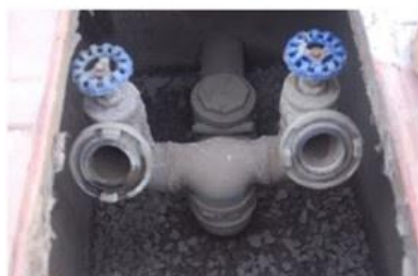
Figura 197 - Hidrante de recalque duplo
