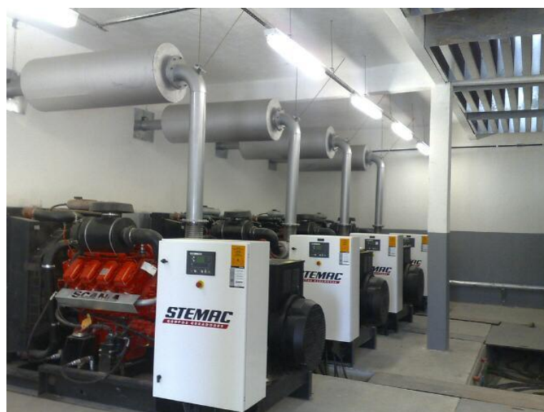
Figura 186 - Grupo moto gerador
