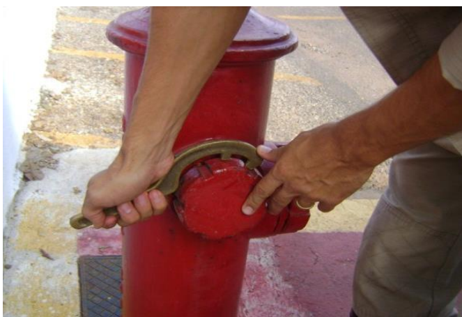
Figura 104 – Abertura do hidrante.
