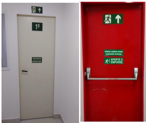
Figura 169 - Porta corta fogo
