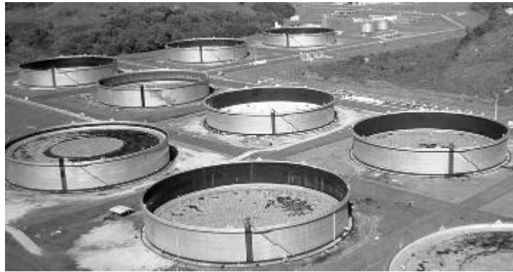
Figura 32 - Tanques de teto flutuante externo.
