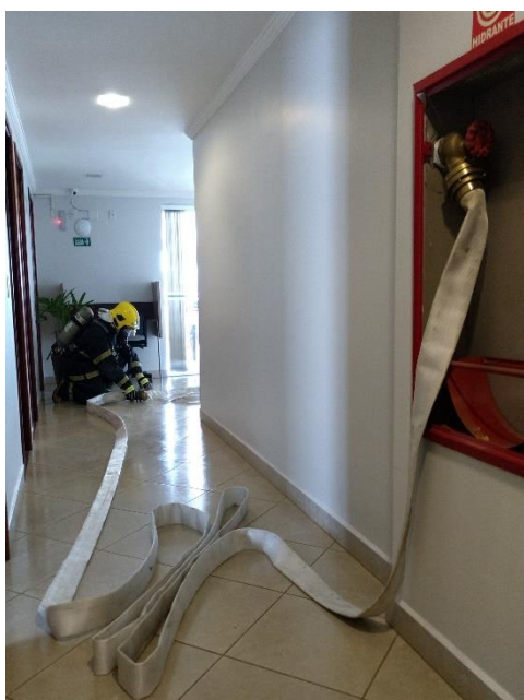
Figura 192 - Ligação conectada do hidrante ao divisor
