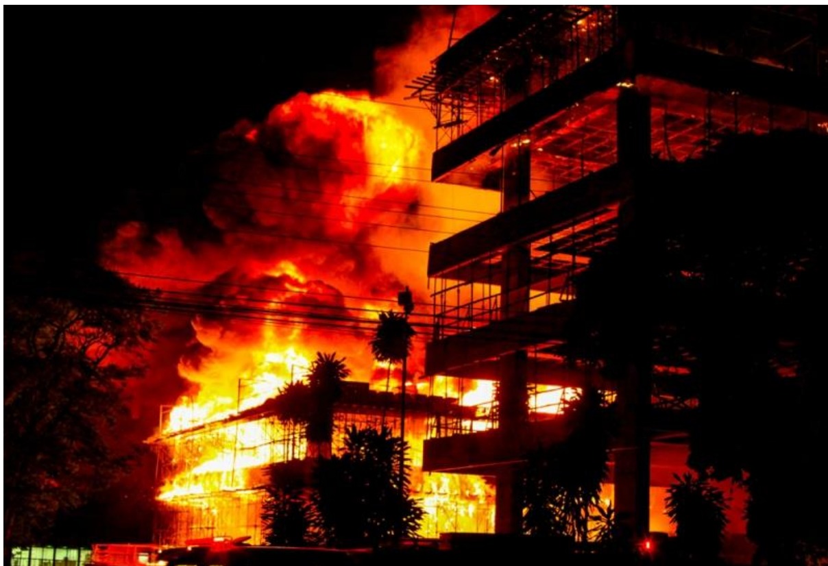
Figura 272 - Incêndio Prédio em Construção do TRT - Goiânia – 2015
