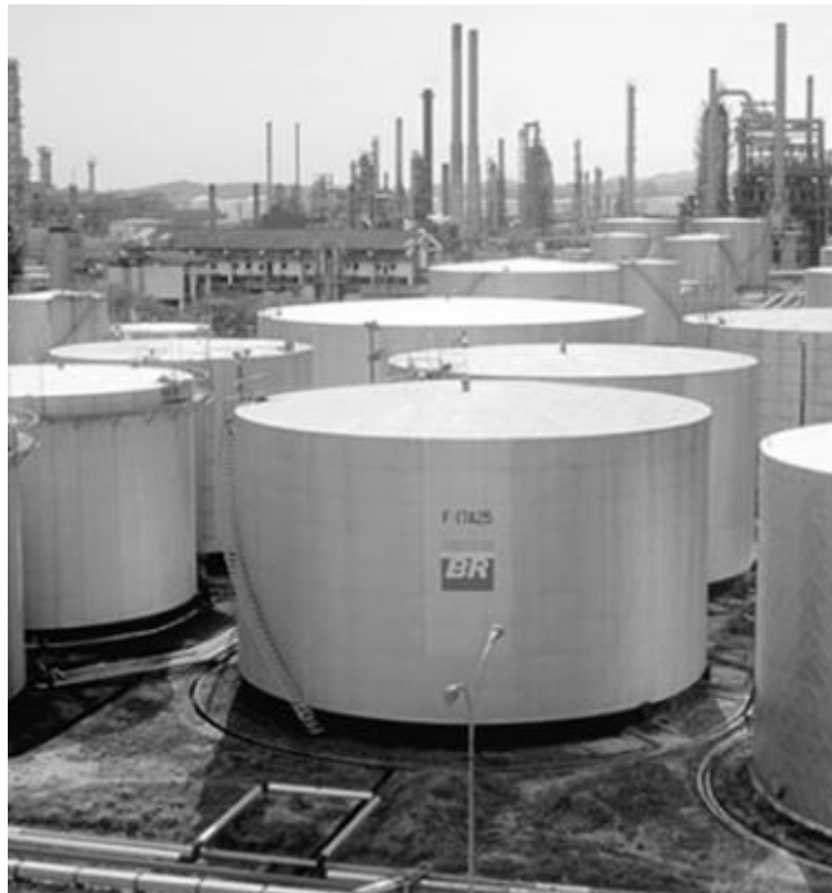
Figura 31 - Tanque de teto fixo.
