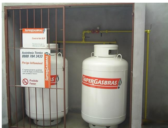
Figura 190 - Central de GLP
